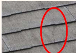
スレートのクラック
