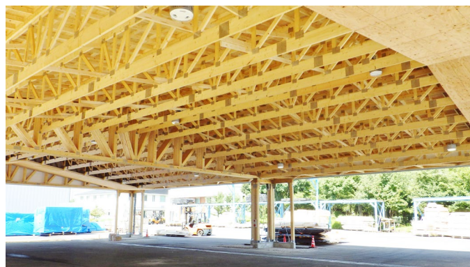
スマート倉庫内観
